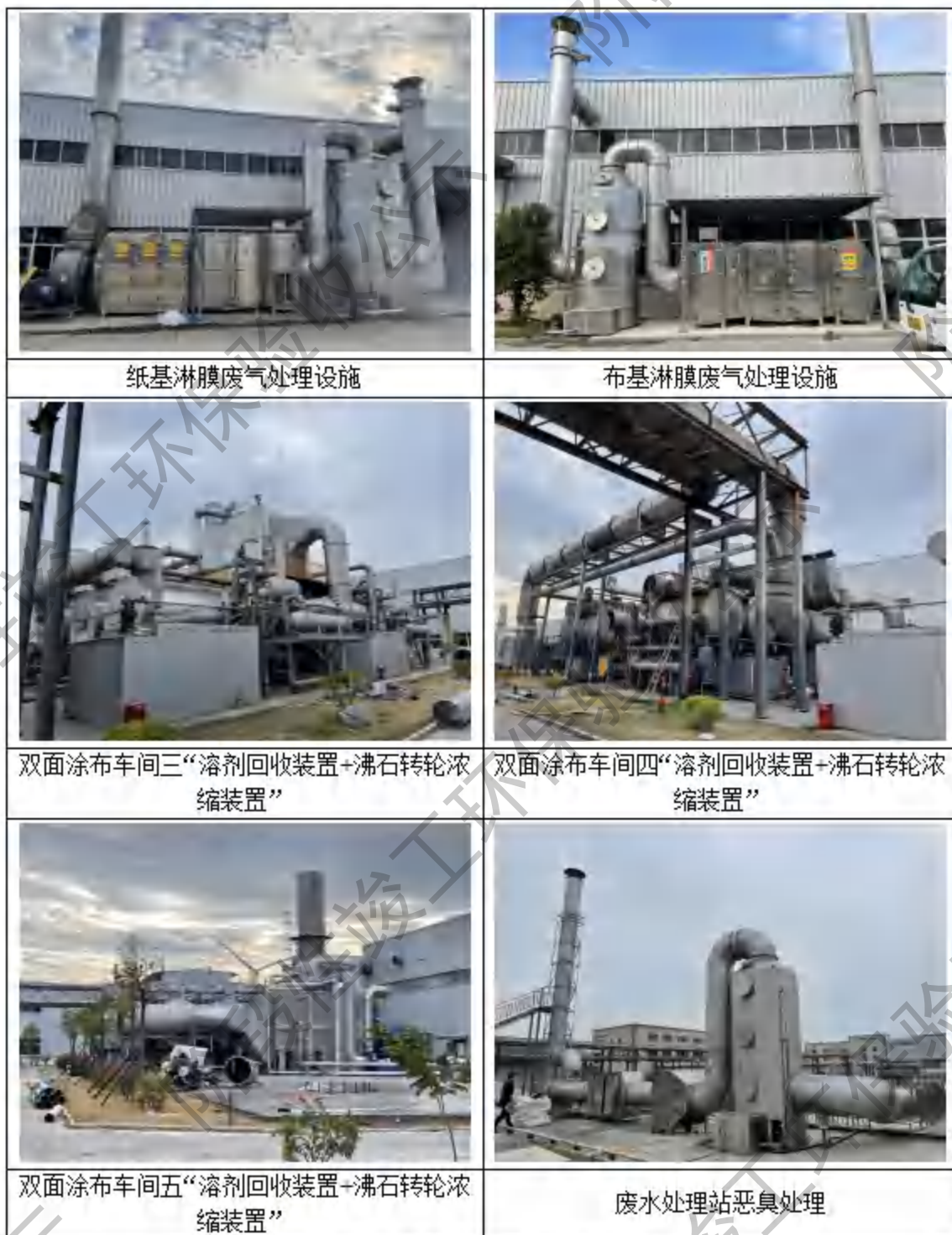
图 4.1-4 有组织废气治理设施
