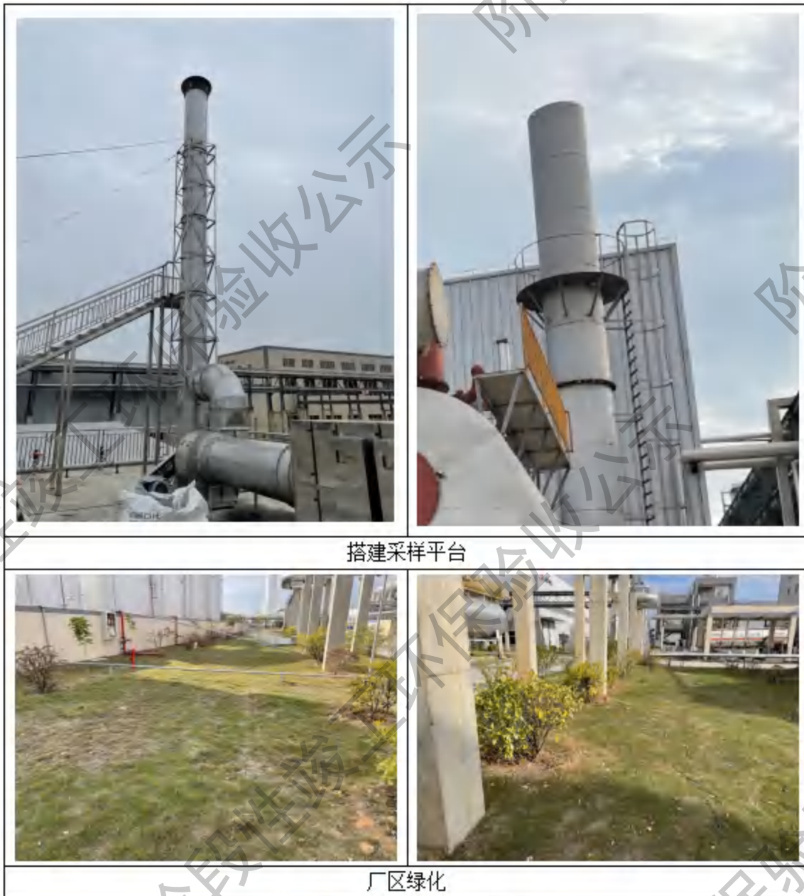
图 4.2-2 监测设施建设化情况
